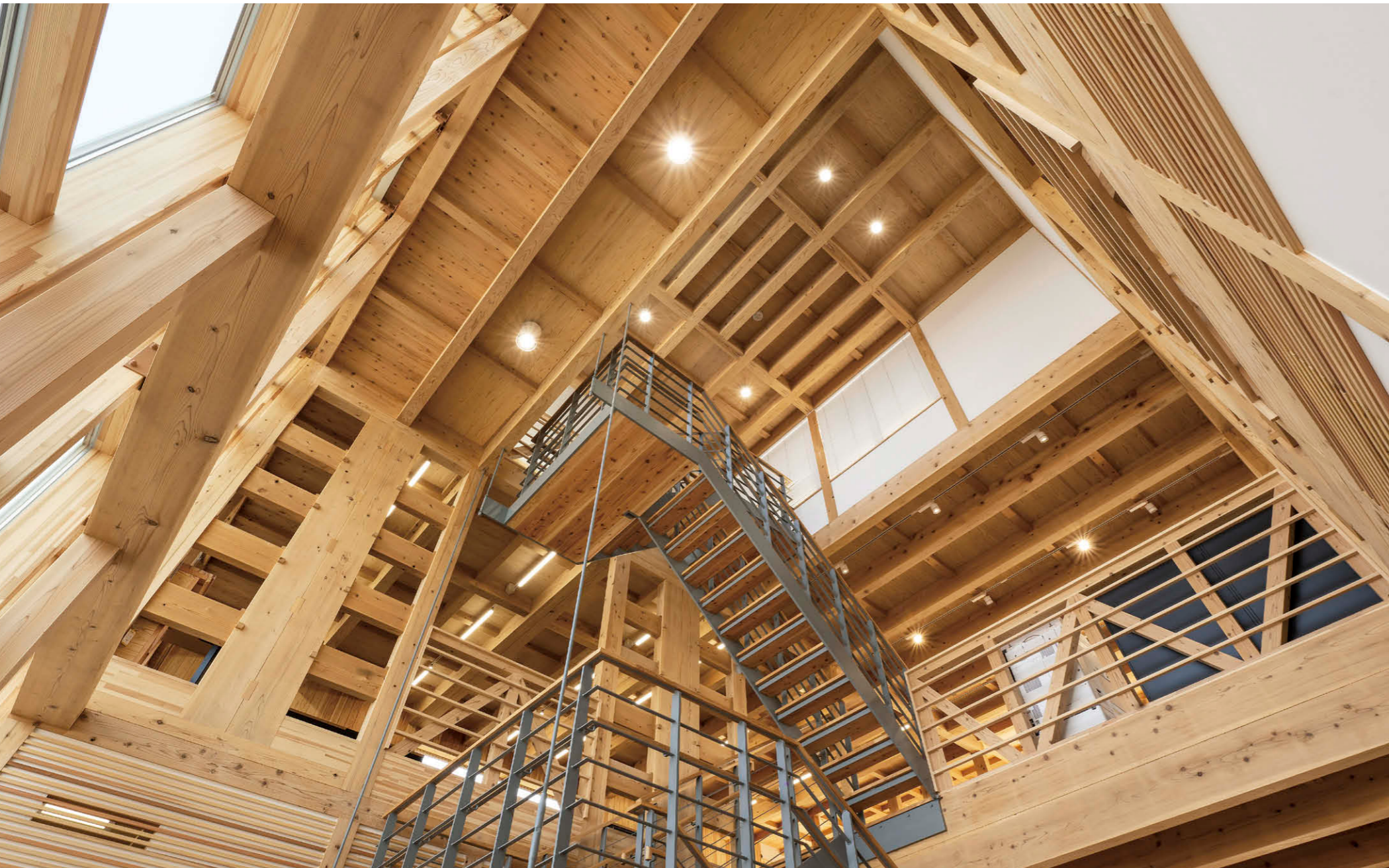
エントランスホール(吹抜) LEDユニット交換形ダウンライト①とLEDシーリングダウンライト②を併用し消費電力を削減。
