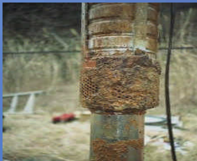
揚水機吸込部に付着したスケール
