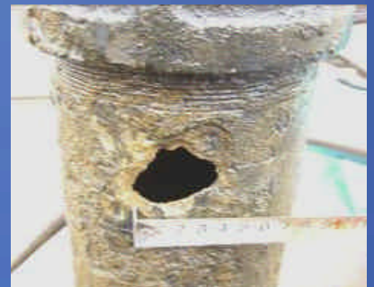
腐食により破孔した揚水管
