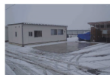
地下水熱交換器による駐車場融雪状況
